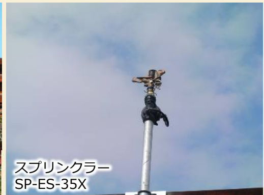
壁に沿って立つ スプリンクラー
