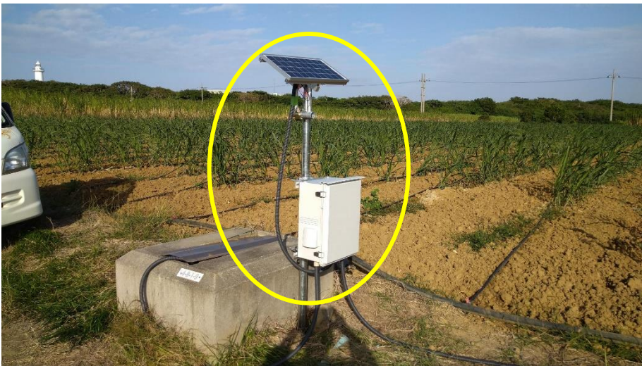
ソーラー制御盤
