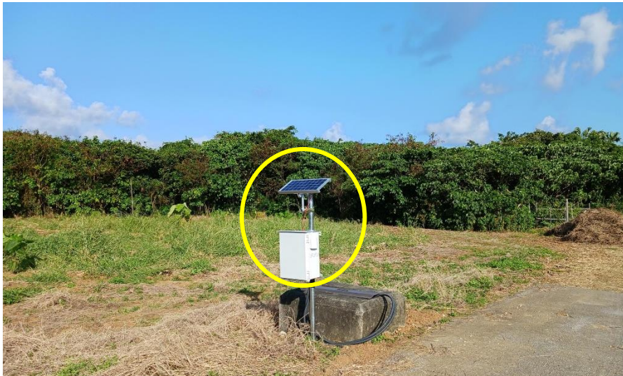
ソーラー制御盤
